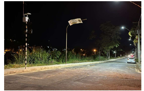
Iluminação de LED na avenida São João
